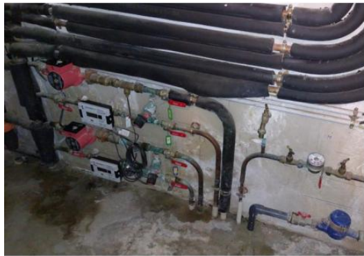
Départs chauffage en cuivre
