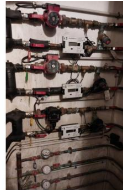
Départs chauffage en cuivre
