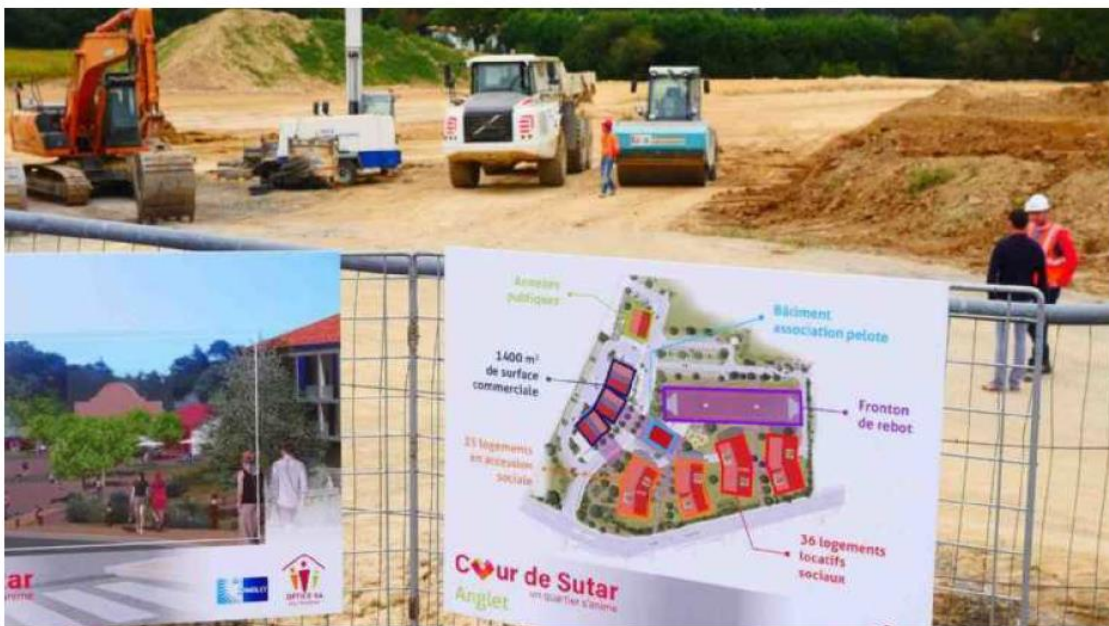
Dans un an et demi, les premières constructions du projet Cœur de Sutar seront sorties de terre. PHOTOS BERTRAND LAPÈGUE
